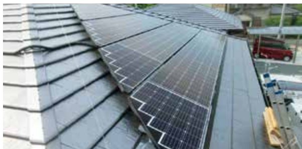
住宅用太陽光発電システム
